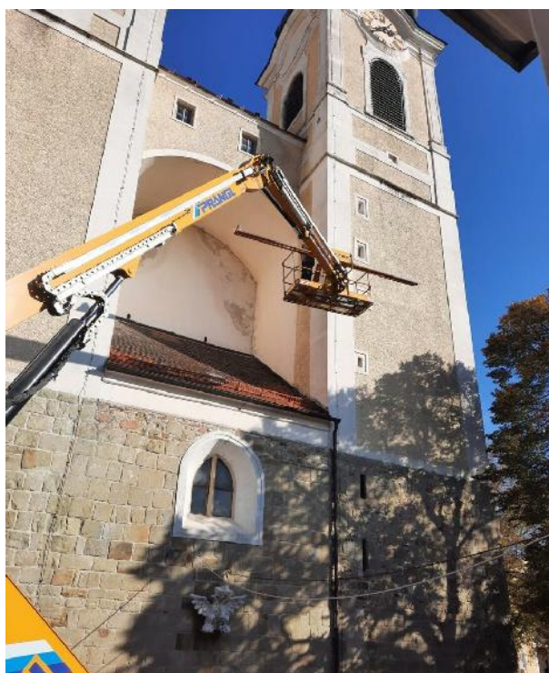
Unser Kirchendach wurde von der Firma Lintner-Dach begutachtet und dringende Ausbesserungsarbeiten wurden vorgenommen. Dazu gehören auch neue Dachrinnen im Bereich der Türmerstube.
